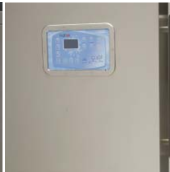
Kontroll-Panel an eine ergonomische Stelle eingebaut
